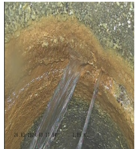
Lekkende riolen in Vaassen
